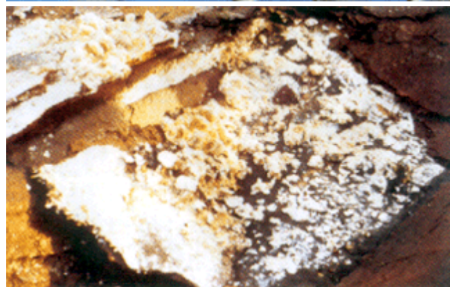
Figur 1. Voldsomt angreb af svampe i både underlag for tagpap og bærende ribber i tagkonstruktion.
